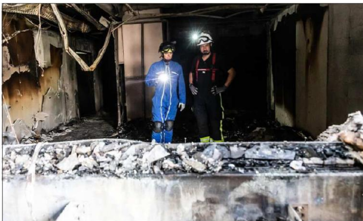
Les pompiers ont identifié la pièce d'où est parti le feu: la salle TV.
